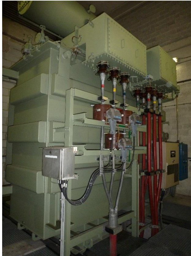
Figuur 1.3: Ondergrondse kabels aangesloten op een transformator
