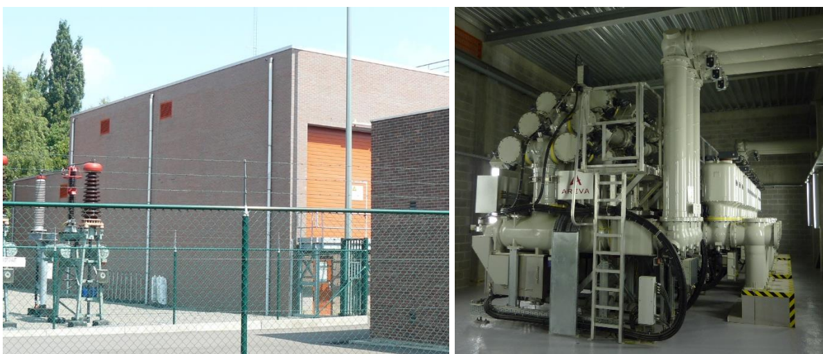
Figuur 1.5: 150 kV onderstation van het type GIS
