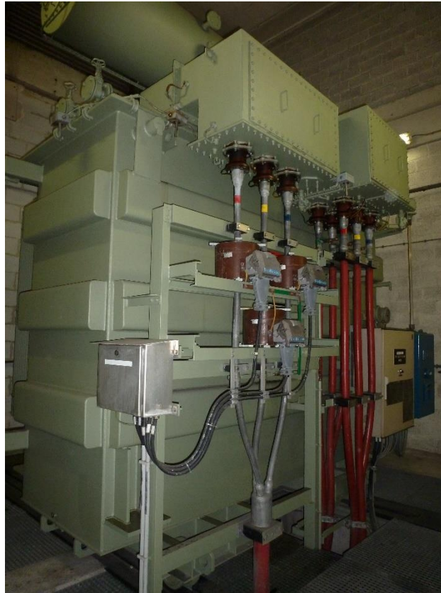
Figure 1.3 : câbles souterrains connectés sur un transformateur
