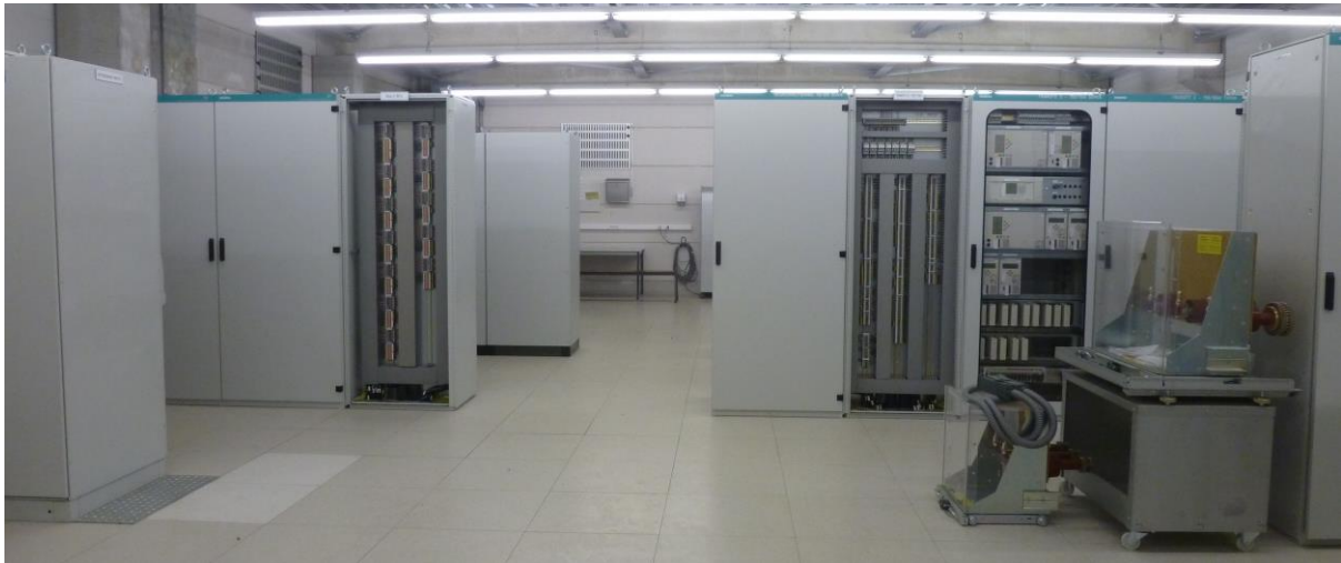
Figure 1.6 : équipements secondaires d'une sous-station
