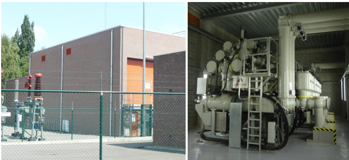
Figure 1.5 : sous-station 150 kV de type GIS
