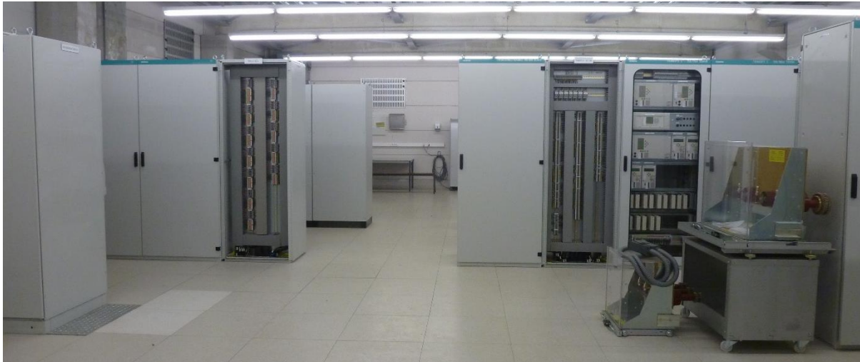
Figuur 1.6: secundaire uitrustingen van een onderstation
