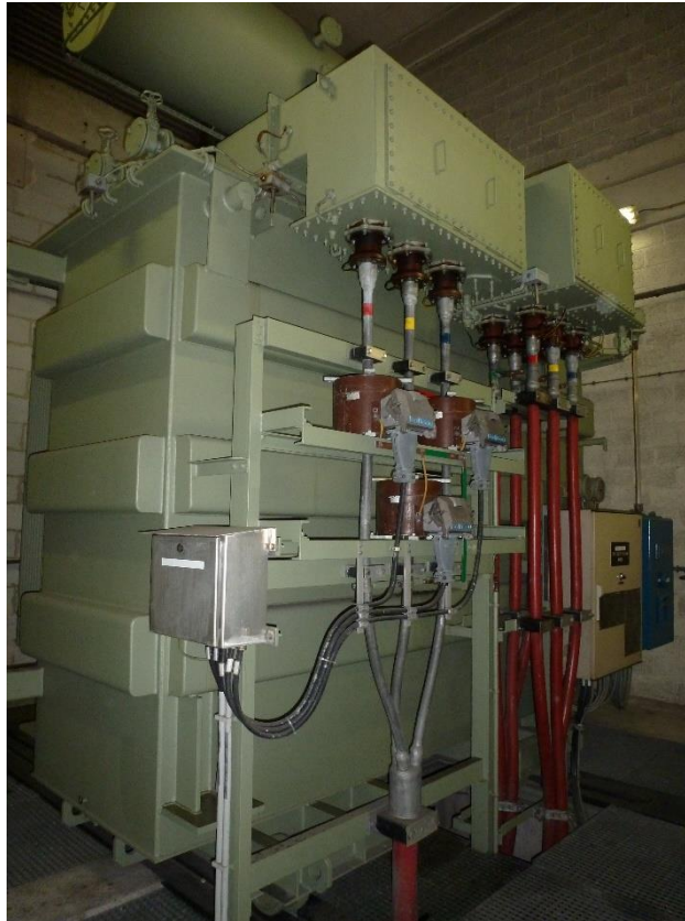
Figuur 1.3: Ondergrondse kabels aangesloten op een transformator
