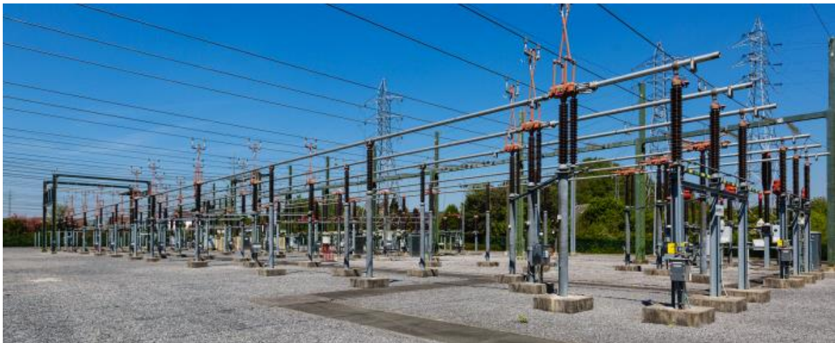
Figuur 1.4: 150 kV onderstation van het type AIS
