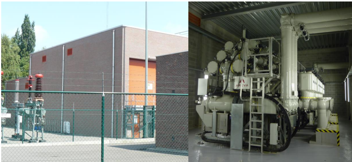
Figure 1.5 : sous-station 150 kV de type GIS
