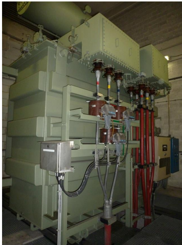
Figure 1.3 : câbles souterrains connectés sur un transformateur
