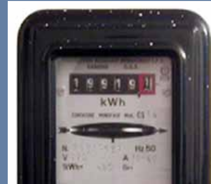
Compteur électricité simple
